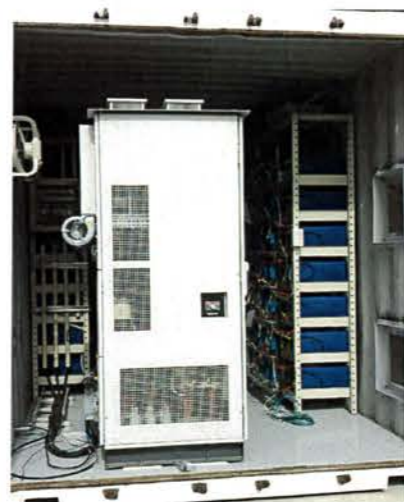
充放電システム (PCS 50kW)
