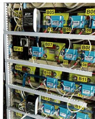
4V450Ah蓄電池 (@20Hr.) ×60 直列×3並列=324kWh
