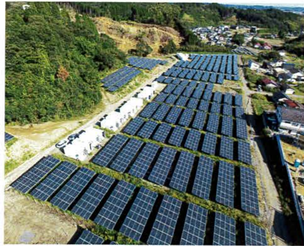
PVパネル: 1.1MW バッテリー (20ft) コンテナ: 22基
